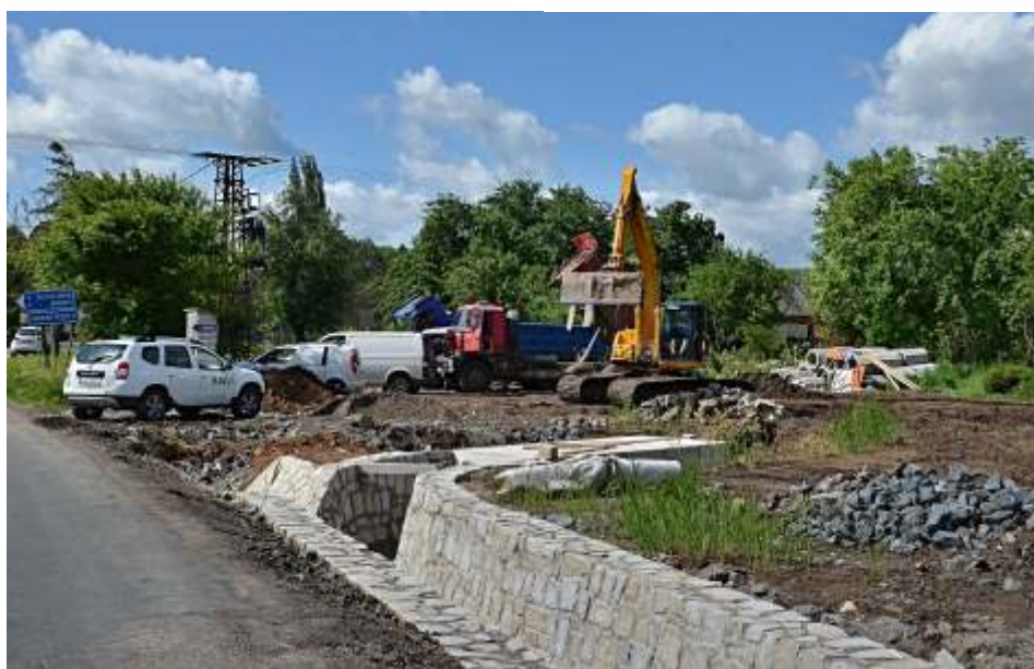
Protipovodňový kanál protíná celou ves - foto Milan Pospíšil
